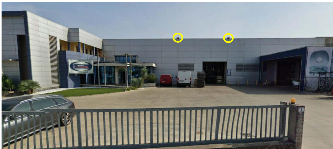
Figura 58: corpi luminosi installati
