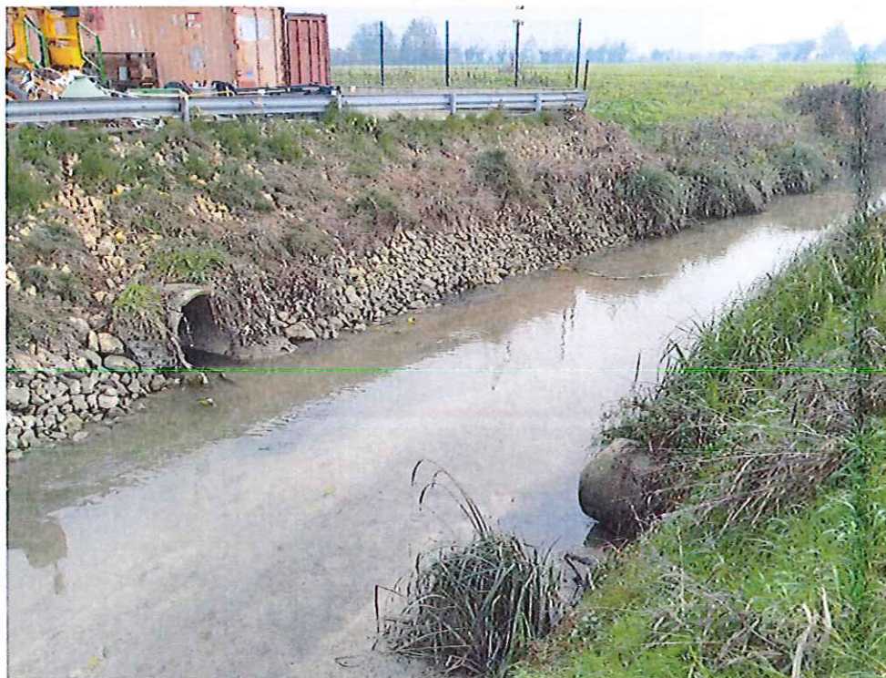
FOTO N° 34 : altra panoramica della sezione n° 14 di rilievo con osservabili le due condotte descritte in precedenza.
