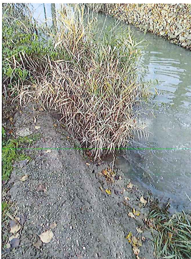
FOTO N° 20 : sbocco dello scarico delle acque produttive depurate con tubazione in PVC D = 400 mm nascosto dai cespugli spondali, con visibile in primo piano la cappa di calcestruzzo realizzata a protezione nei riguardi dei fenomeni erosivi della sponda.
