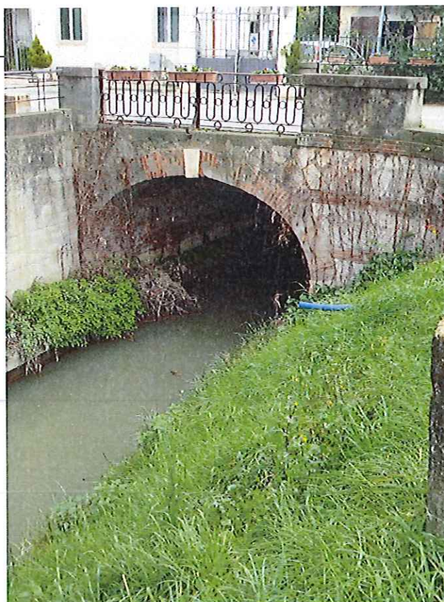
FOTO N° 10 : veduta del ponte di via S. Sepolcro, interessato da lavori di consolidamento fondazionale a seguito di scalzamento del fondo alveo nel 2005.
