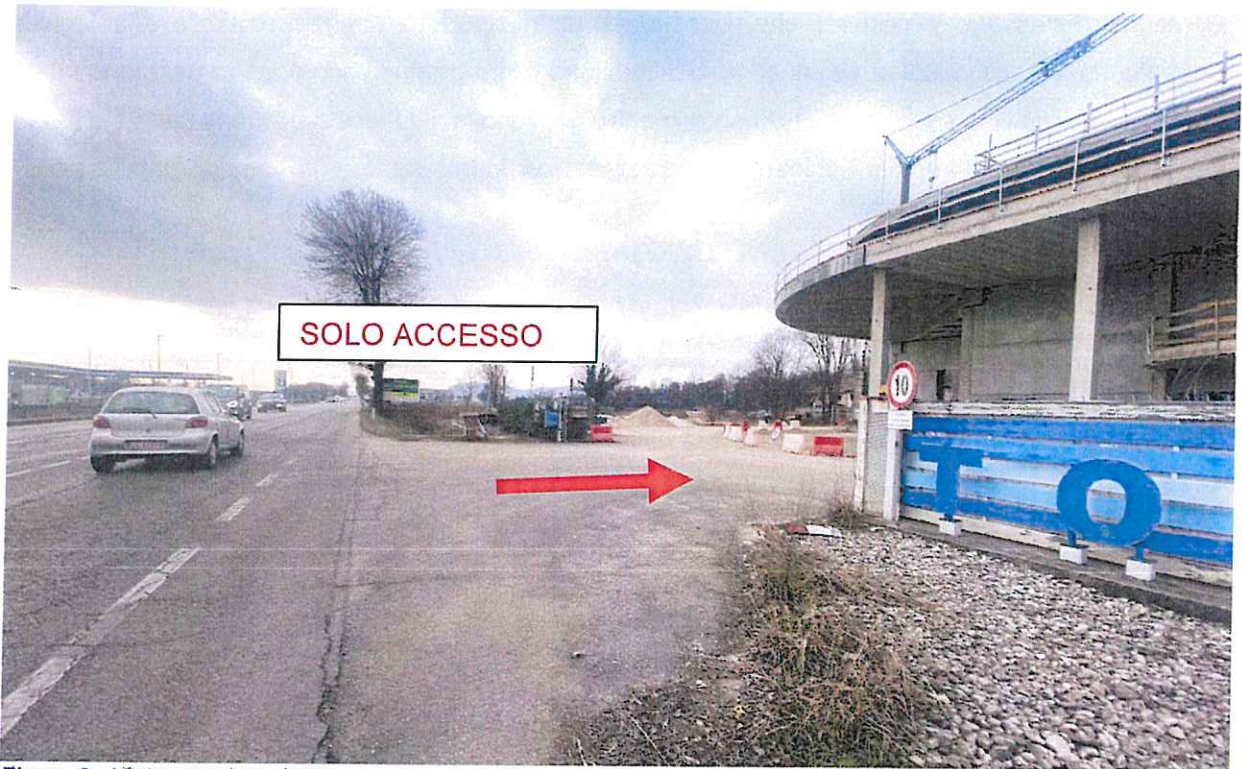
Figura 2 - Vista angolare dell'accesso sud al sito produttivo oggetto di studio (ingresso veicoli)
