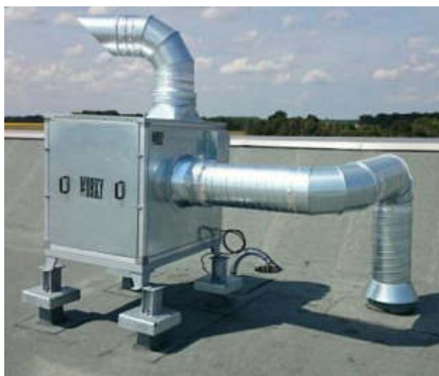
Figura 52: Impianto di aspirazione.
