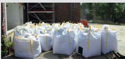
Materiale in MMMF, compresso e versato in sacconi big-bag direttamente davanti ad un oggetto in demolizione
