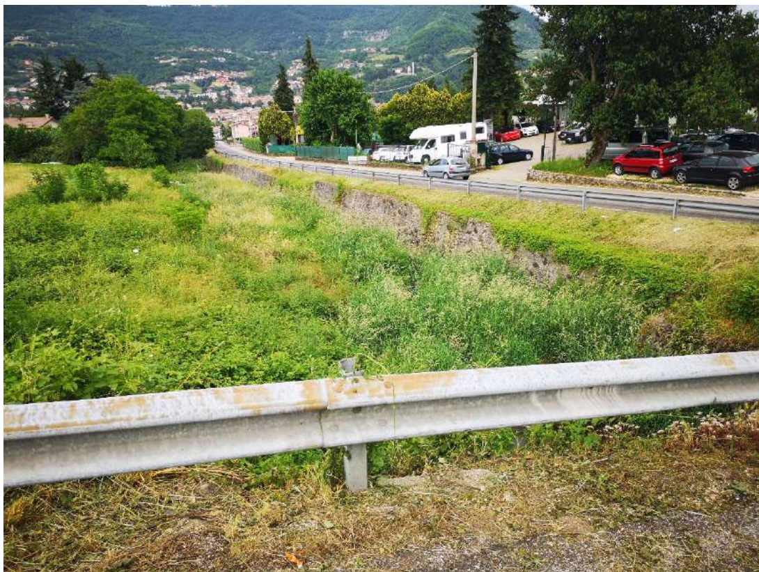
Foto della valle Preona a valle ponte via Gonzati; si nota come la valle sia incassata rispetto area residenziale di via Griggio e l'alveo sia largo;
