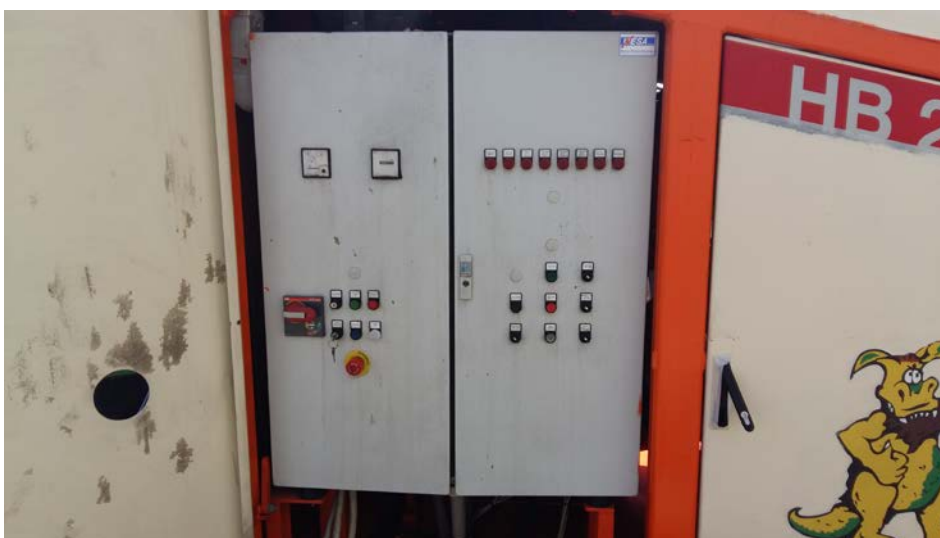
Illustrazione quadro elettrico
