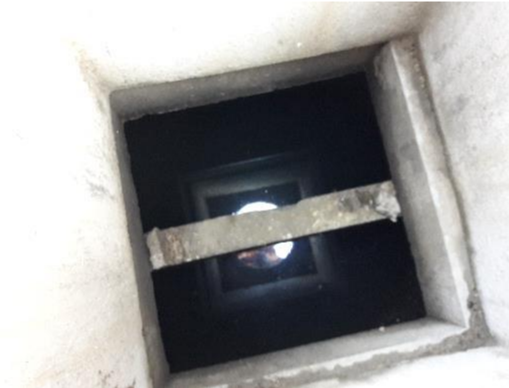
Figura 3. Parte finale del sistema trattamento (filtro a coalescenza); si nota la presenza di acqua, segno che le vasche sono integre e a tenuta idraulica
