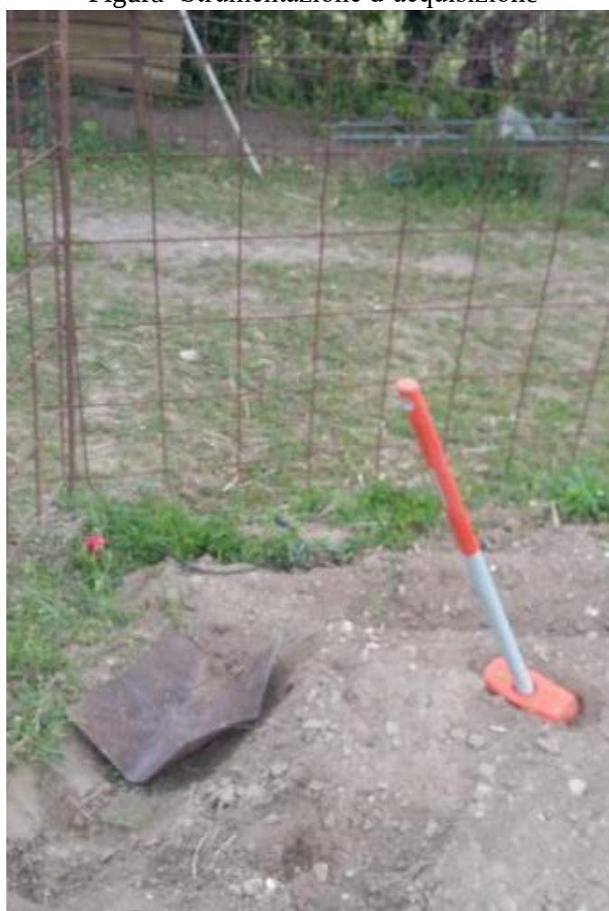
Figura- Strumentazione di energizzazione.
