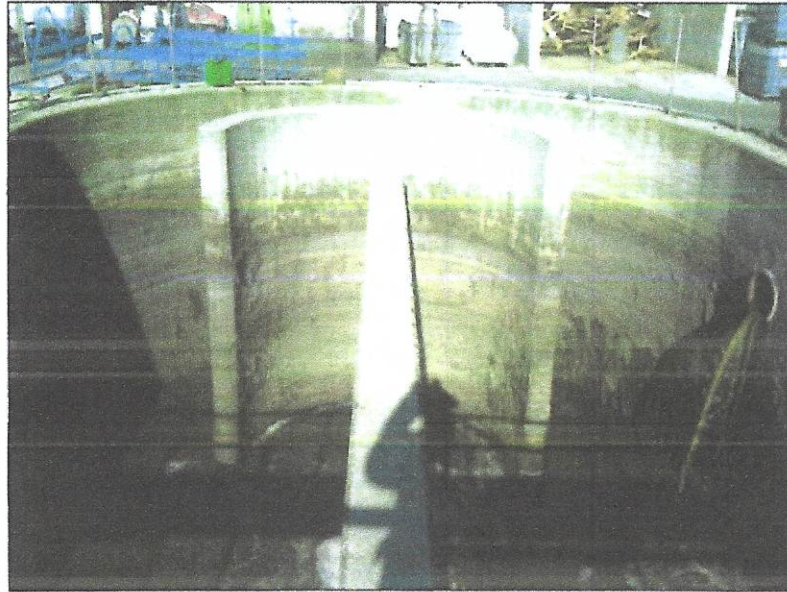
Foto 2 – Vasca di omogenizzazione
