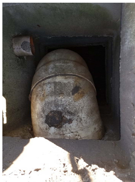
Figura 4: Tubazione di scarico DN 500 in PVC per lo scarico della copertura dell'edificio commerciale posto a sud
