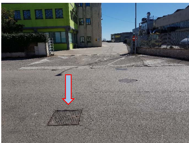
Figura 5: Punto di scarico delle acque meteoriche nella fognatura bianca di viale Europa.
