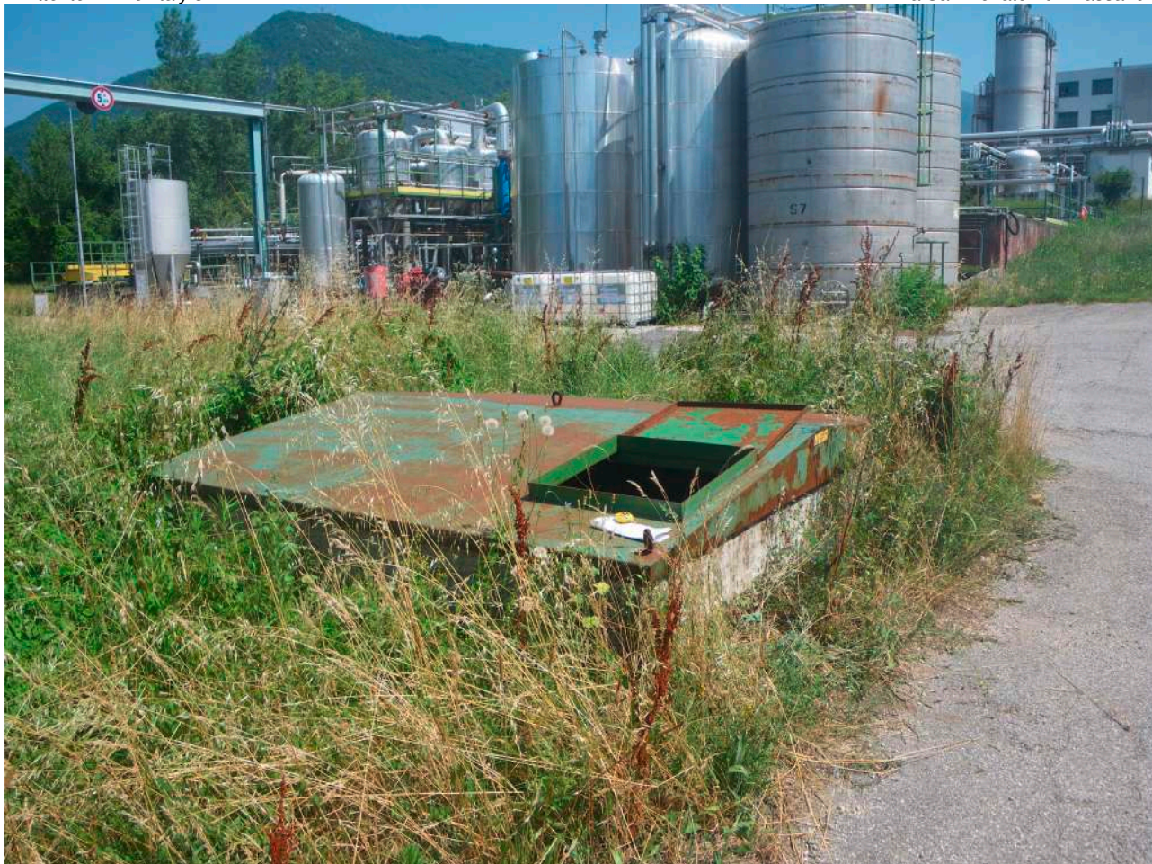
Foto N.5 : Ubicazione del Pozzo P3 di approvvigionamento idrico autonomo dello stabilimento non utilizzato
