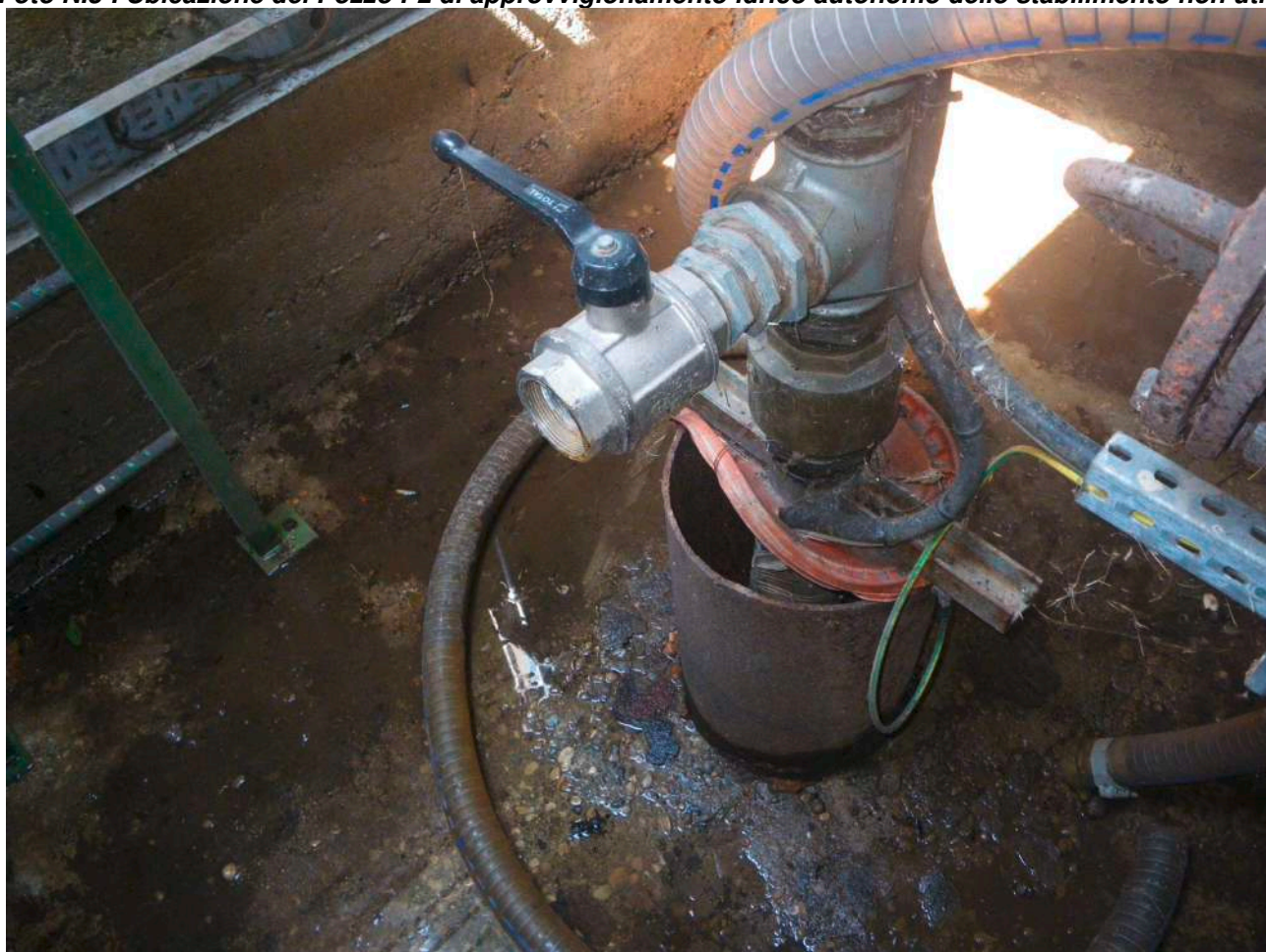
Foto N.4 : Testa del Pozzo P2 di approvvigionamento idrico autonomo da 300mm non utilizzato attualmente
