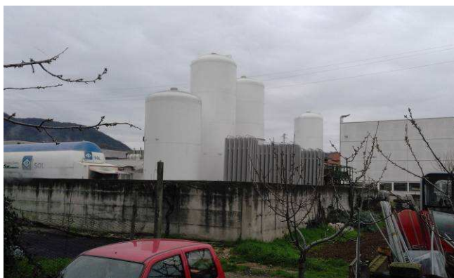
Foto n.14 : Impianto di azoto
