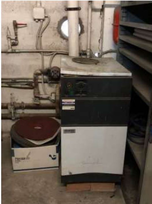
La caldaia dismessa.
