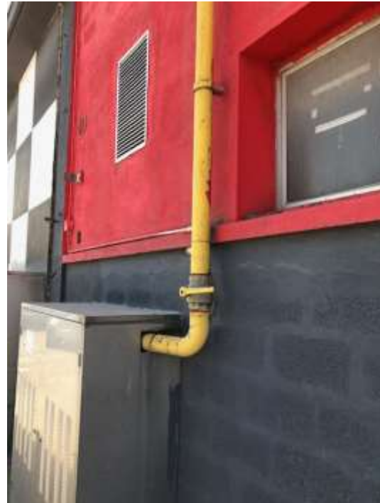
Tubo del gas metano di alimentazione della caldaia dismessa.
