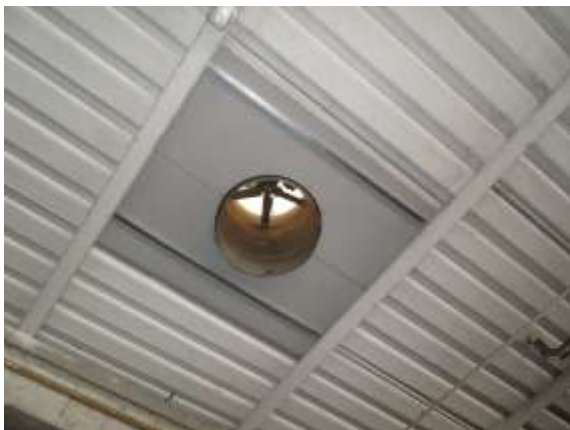
Elettroventilatore di immissione aria.
