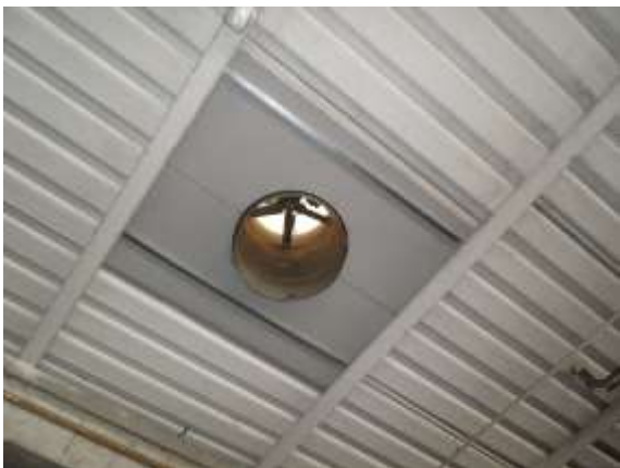
Elettroventilatore di immissione aria.
