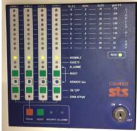
Pannello di controllo della centralina di monitoraggio.
