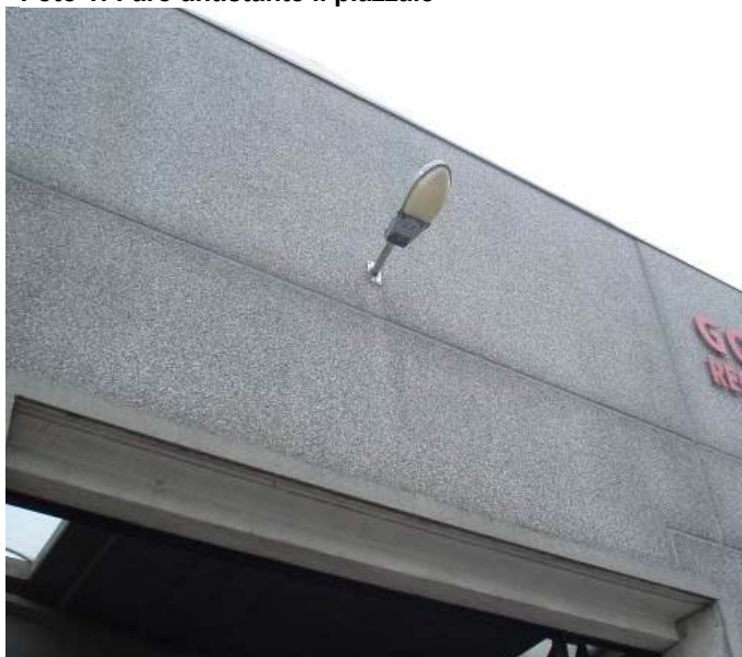
Foto 2: Illuminazione del capannone
