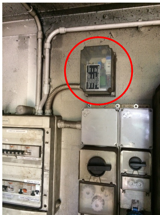
Figura 3 – impianto di pretrattamento – foto del quadro d'allarme
