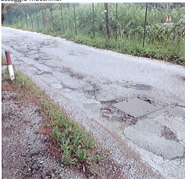
FOTO 5: Stato devastato della strada Via Cappuccini (S1) e presenza di un tombino con bordi sbrecciati
