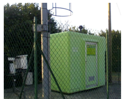
Stazione fissa ARPAV di Montebello V.
