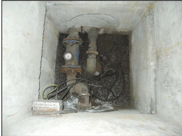
Foto 1: Pozzettone di contenimento testa pozzo
