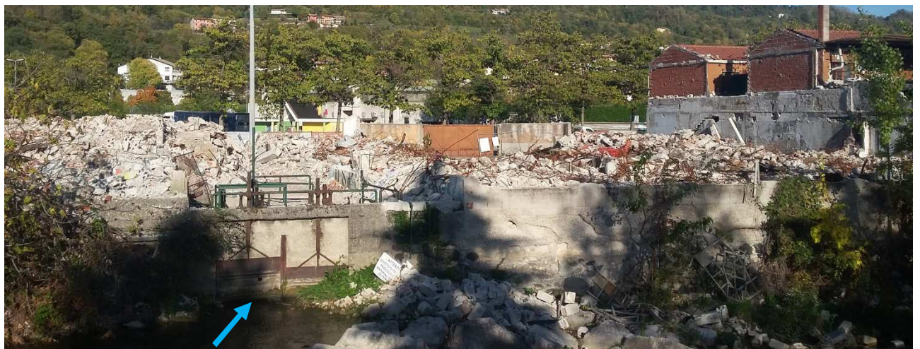
Figura 11 – Visuale in direzione est, in primo piano l'opera di presa, cono visuale CV_5
