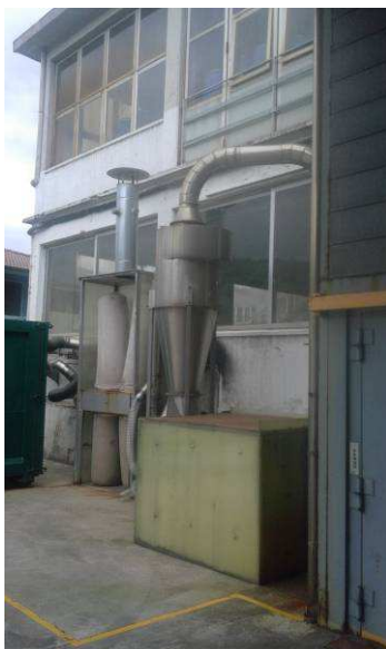
Foto n.16 : Impianto di aspirazione aria e abbattimento polveri
