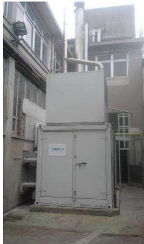
Foto n.14 : Impianto di cogenerazione della Conceria Tolio S.p.A.
