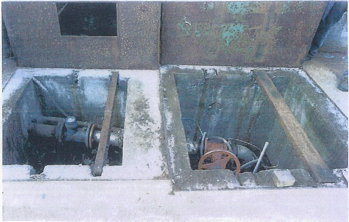
FOTO n° 1 : veduta d'assieme dei due pozzetti; sono individuabili, nel primo pozzetto, la saracinesca di regolazione e, nel secondo, il contatore tipo Woltmann
