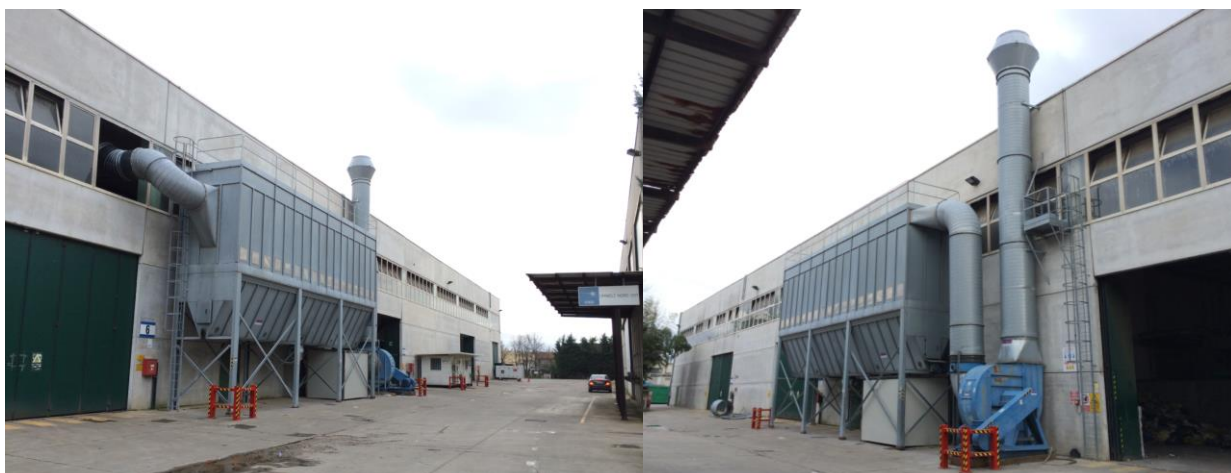
Foto 5. Viste dell'impianto di filtrazione. Si noti la cabina insonorizzata per la riduzione del rumore prodotto dall'impianto pneumatico.
