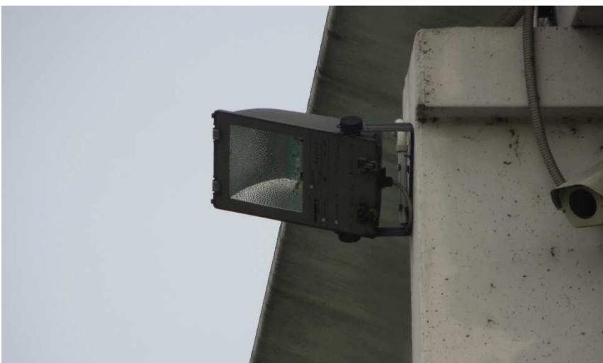
Figura 6: Proiettore esterno relativo alla parte di capannone attualmente in uso per la linea di trattamento dei R.A.E.E. e già a norma rispetto alla L.R. 17/2009
