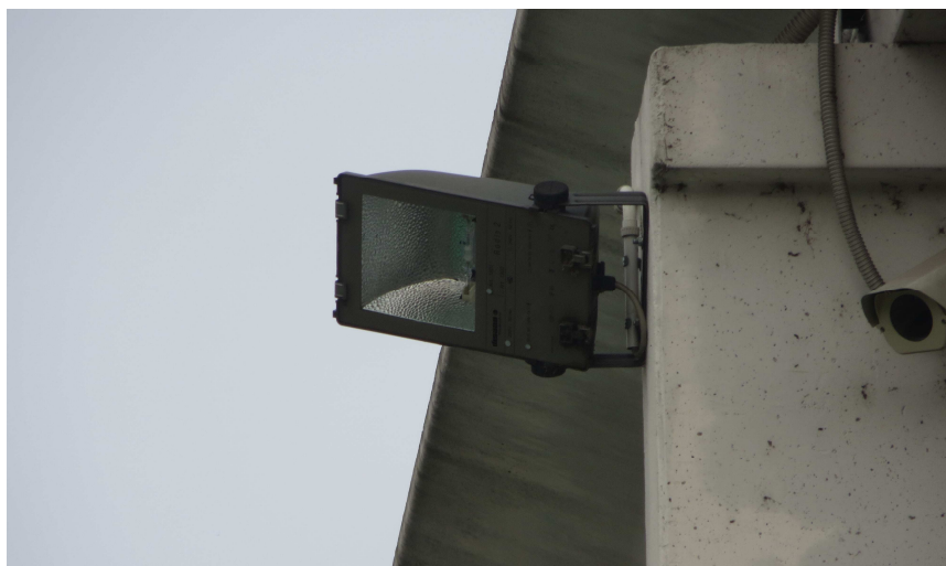
Figura 21: Proiettore esterno relativo alla parte di capannone attualmente in uso per la linea di trattamento dei R.A.E.E. e già a norma rispetto alla L.R. 17/2009
