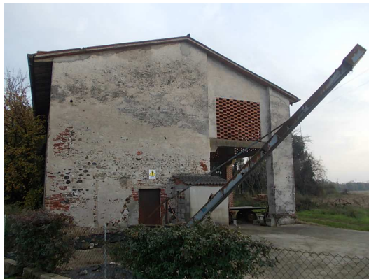
Foto n. 2: Ricettore sensibile R1 (abitazione disabitata ed in precarie condizioni strutturali)
