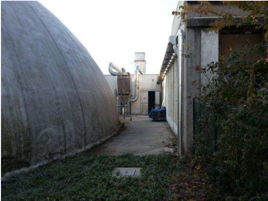
11. Filtro a maniche e camino 1
