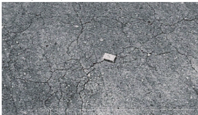
quadro fessurativo superficiale di una pavimentazione
