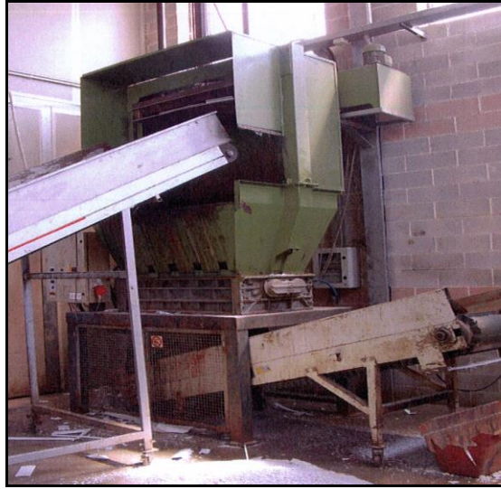
Figura 58: Trituratore Satrind – capannone n.1
