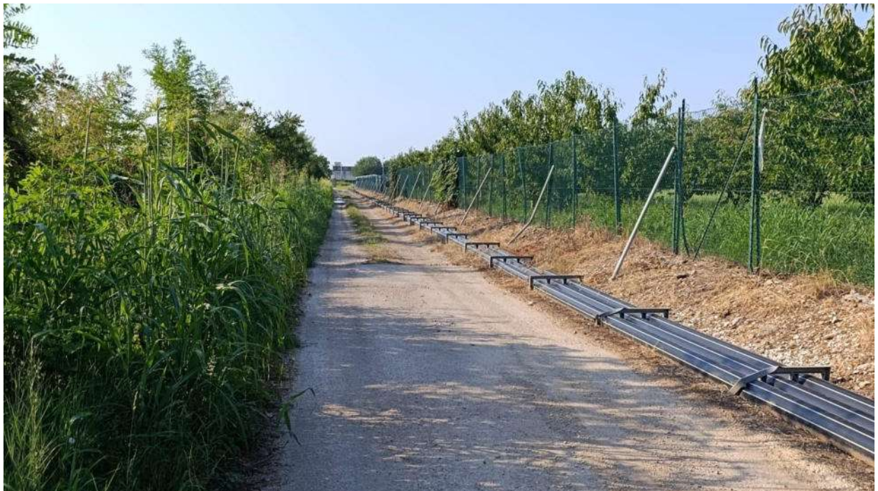
Foto 12: vista della strada di accesso alla sommità discarica vista da nord verso sud e delle condotte in HDPE di trasporto del biogas all'ex impianto di cogenerazione, che verranno riconvertite a condotte del percolato, verso il nuovo campo serbatoi.
