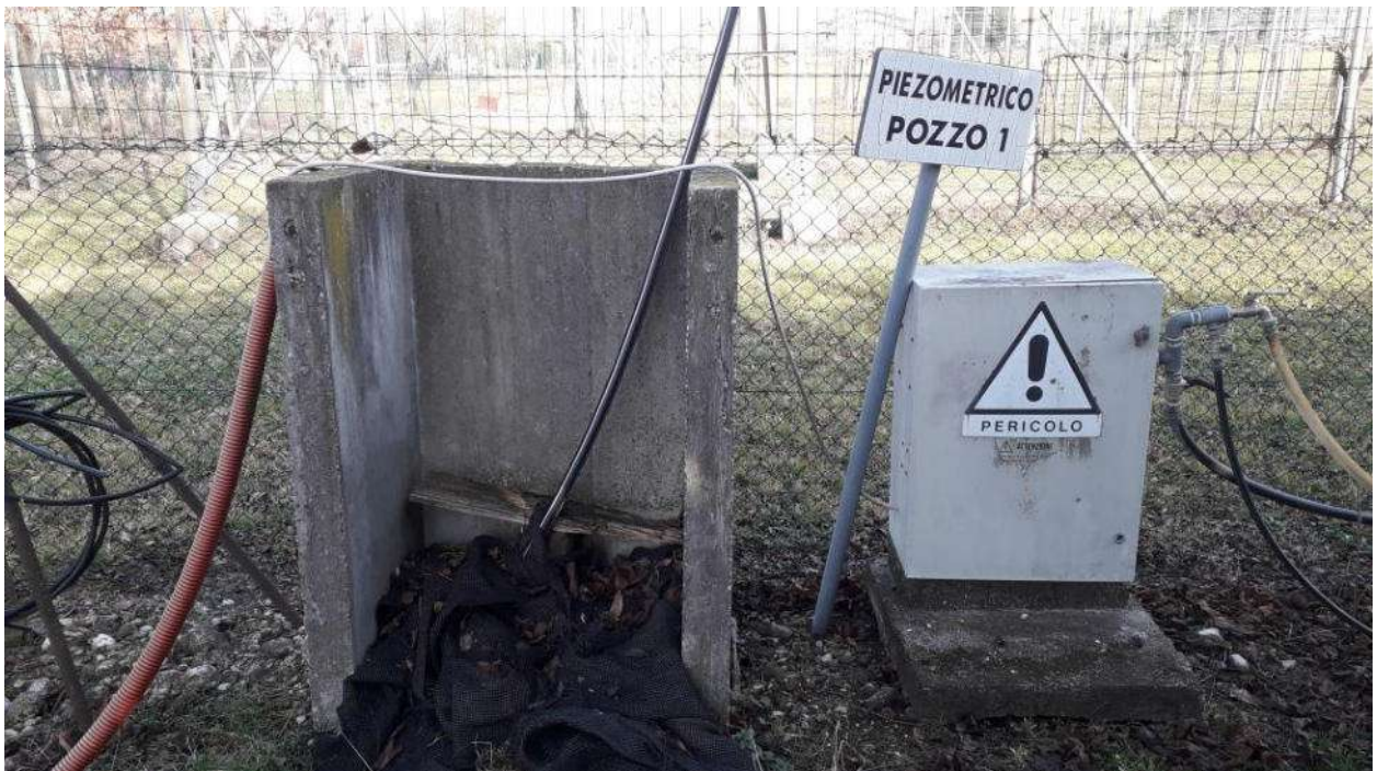
Foto 14: vista del pozzo piezometrico di controllo n. 1 a monte della discarica;
