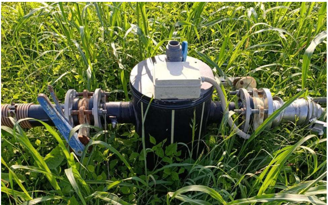
Foto 6: vista di una testa pozzo duale, collegata alle sonde orizzontali del biogas e al ricircolo del concentrato di percolato
