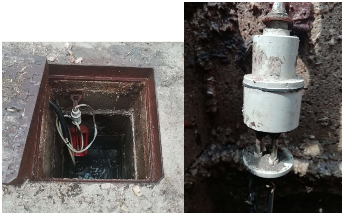
Figura 2. Pozzetto SF2 ove è installata la sonda (a sinistra) e sonda ad este conduttimetriche di passaggio del flusso d'acqua (a destra)
