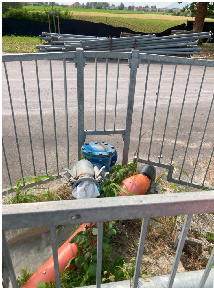
Figura 7 - Il punto di rilancio dei fanghi dalle vasche alla discarica, da qui le tubazioni corrono interrate
