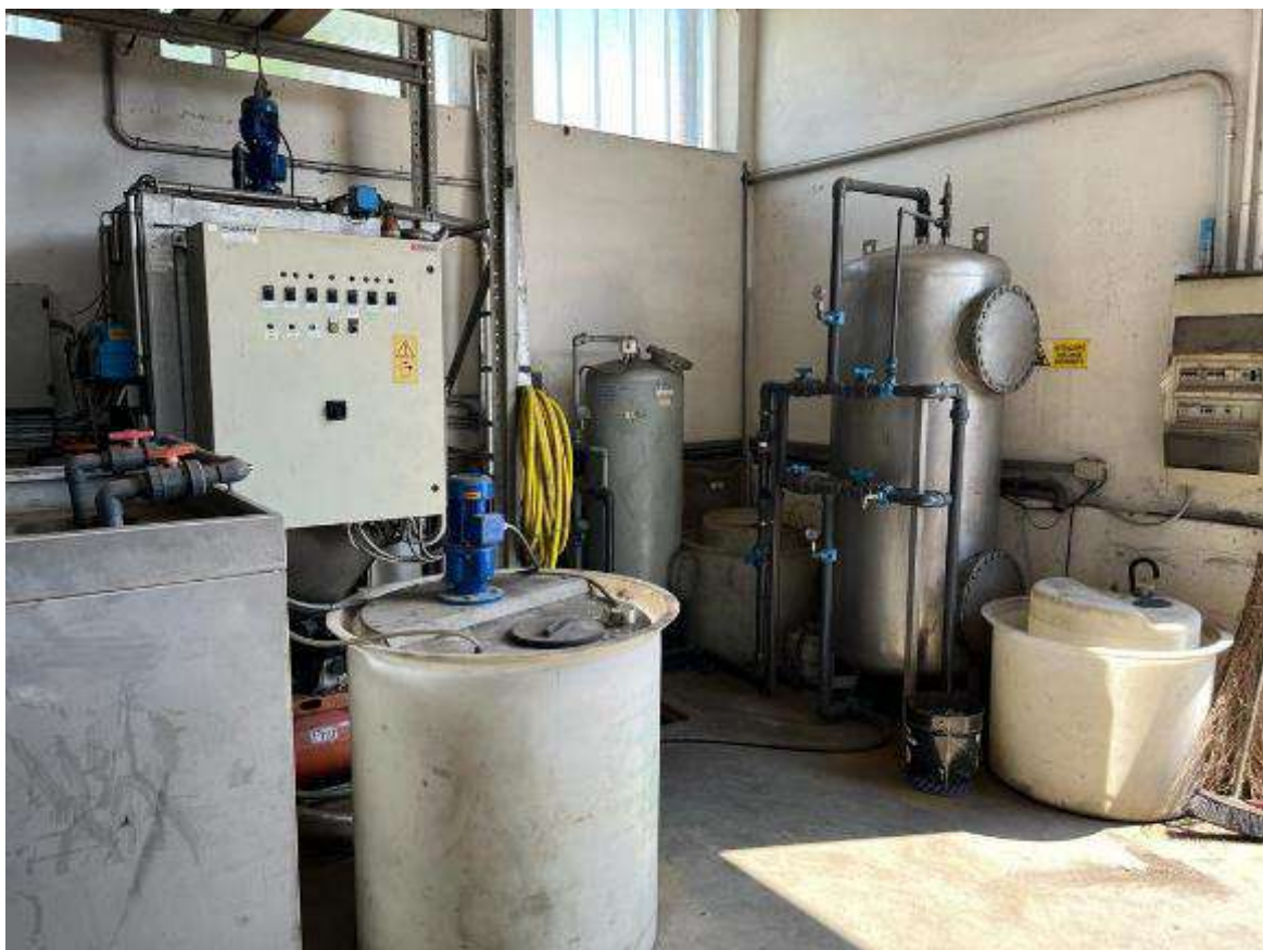
Foto 18 – Sistema di trattamento acque di prima pioggia
