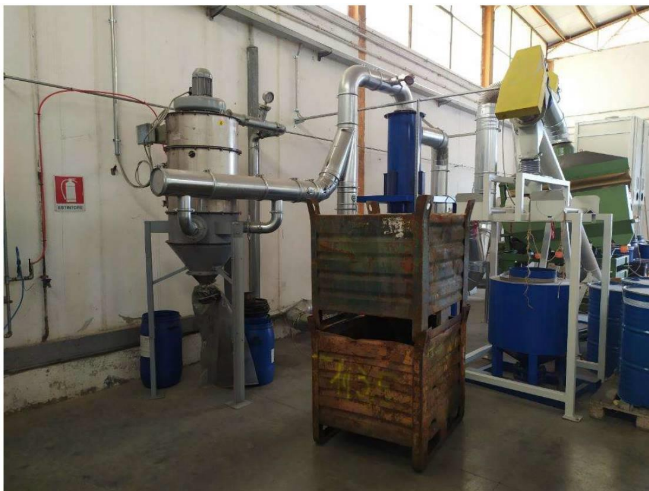
Figura 6. Area dedicate alla lavorazione beni/prodotti: i macchinari verranno rimossi e qui sono previsti i nuovi stoccaggi di rifiuti con installazione di nuova scaffalatura
