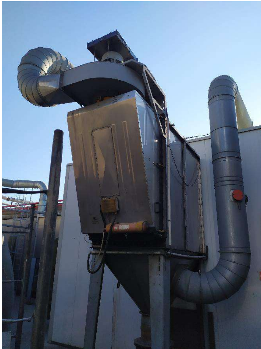
Foto 19. Filtro a maniche camino 1
