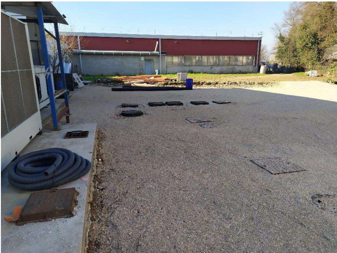
Foto 27. Nuova area trattamento acque
