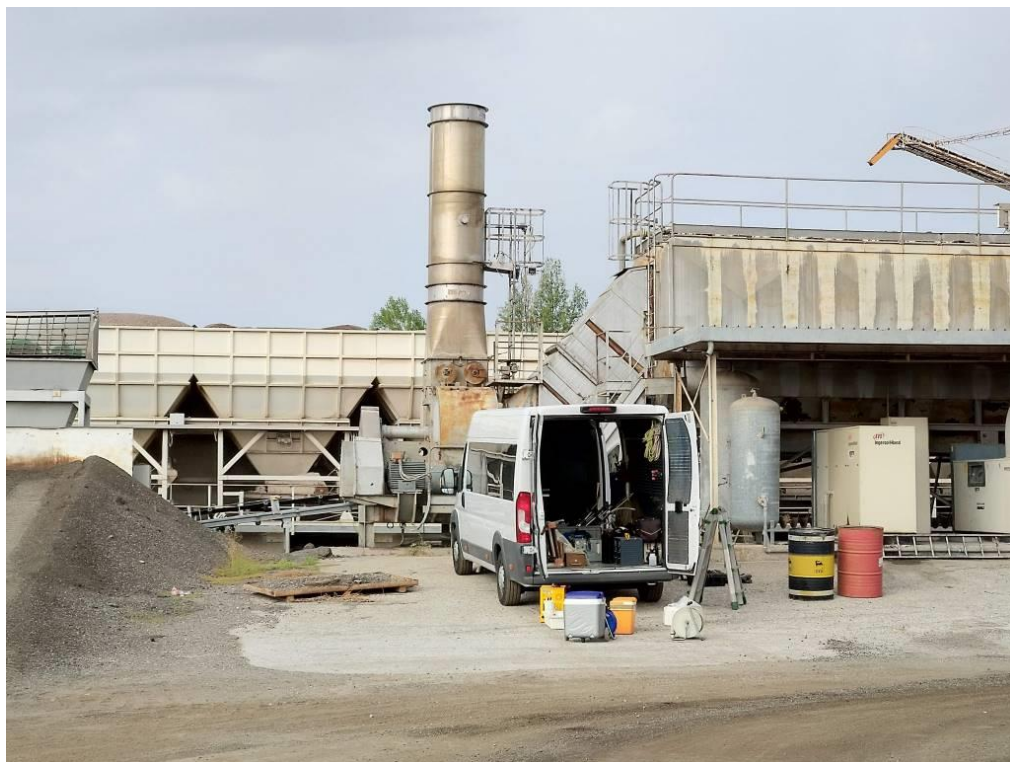
Foto 11 Altra vista del Camino E1 che è il punto di emissione convogliata a valle dell'impianto di abbattimento con filtro a maniche a servizio dell'impianto di bitumaggio e dei fumi dal bruciatore (è in corso la campagna di controllo fumi dei tecnici Analytical).
