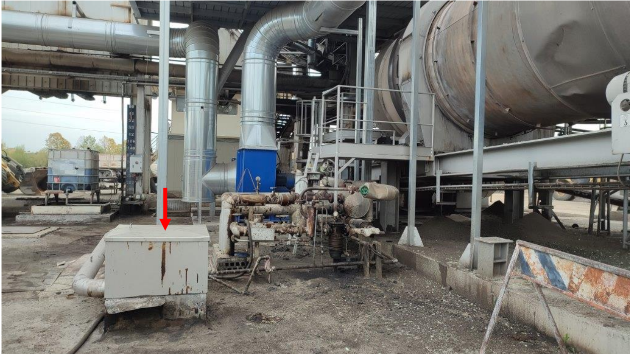
Foto 8 – Vista del chiusino del serbatoio dell'olio pesante BTZ da 80 mc, in fianco al forno, che è stato collegato al bruciatore a seguito dell'autorizzazione temporanea provinciale
