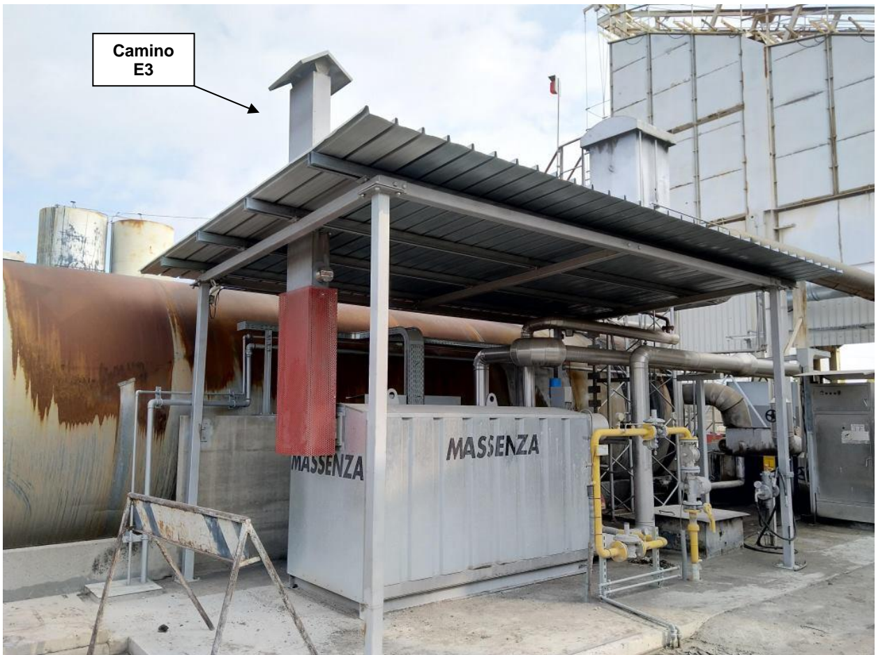
Foto 6 – Caldaia di riscaldamento dell'olio diatermico e dei serbatoi di bitume, alimentata a gas (tubo giallo). Sulla sinistra è presente il camino dei fumi della caldaia, denominato E3
