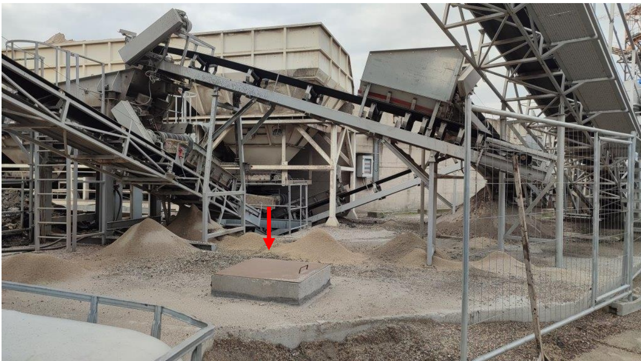
Foto 7 – Vista del chiusino del serbatoio del gasolio già esistente, in fianco al forno, che verrà collegato alla nuova caldaia
