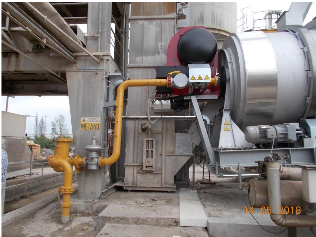
Foto 9 - Dettaglio delle condotte di alimentazione dalla rete del metano al bruciatore del forno essicatore (foto dal collaudo nel 2018) in quanto il bruciatore è predisposto all'alimentazione con diversi combustibili
