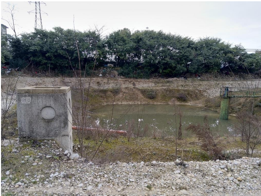
Foto 15 – Panoramica del bacino delle acque di seconda pioggia, e del pozzetto PF3 posto prima dello scarico; sulla sinistra è visibile il manufatto di alloggiamento della pompa di rilancio in testa all'impianto delle acque decantate
