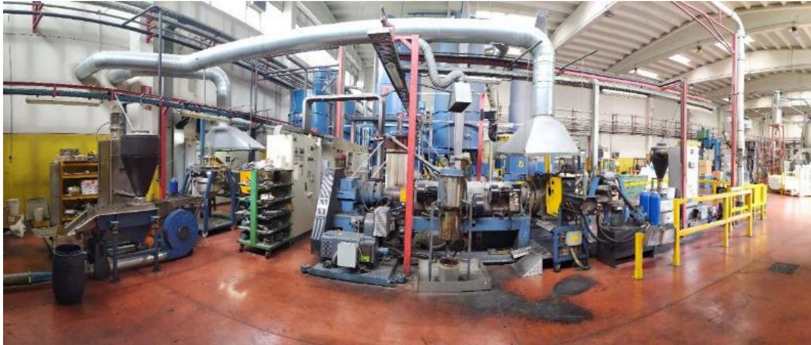
Foto 38. Panoramica area estrusori
