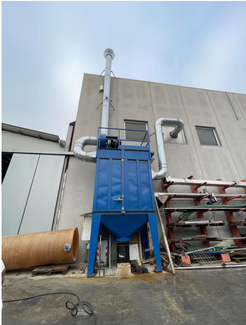
Figura 2: camino 3 e sistema di abbattimento presente.
