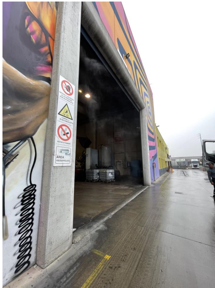
Figura 6: sistema di nebulizzazione installato sui portoni.
