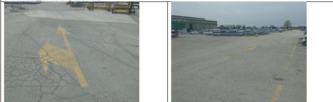
C - Area Stoccaggio materiale grezzo/zincato
