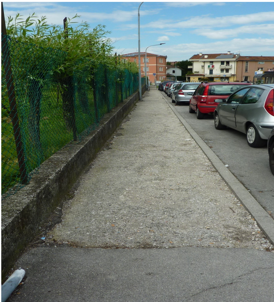
Foto 11: stato attuale di alcuni tratti di marciapiedi
